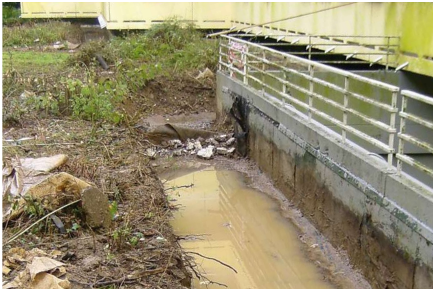
Sanierung unumgänglich: Stehendes Wasser führte zu Schäden im Inneren der Tiefgarage.
