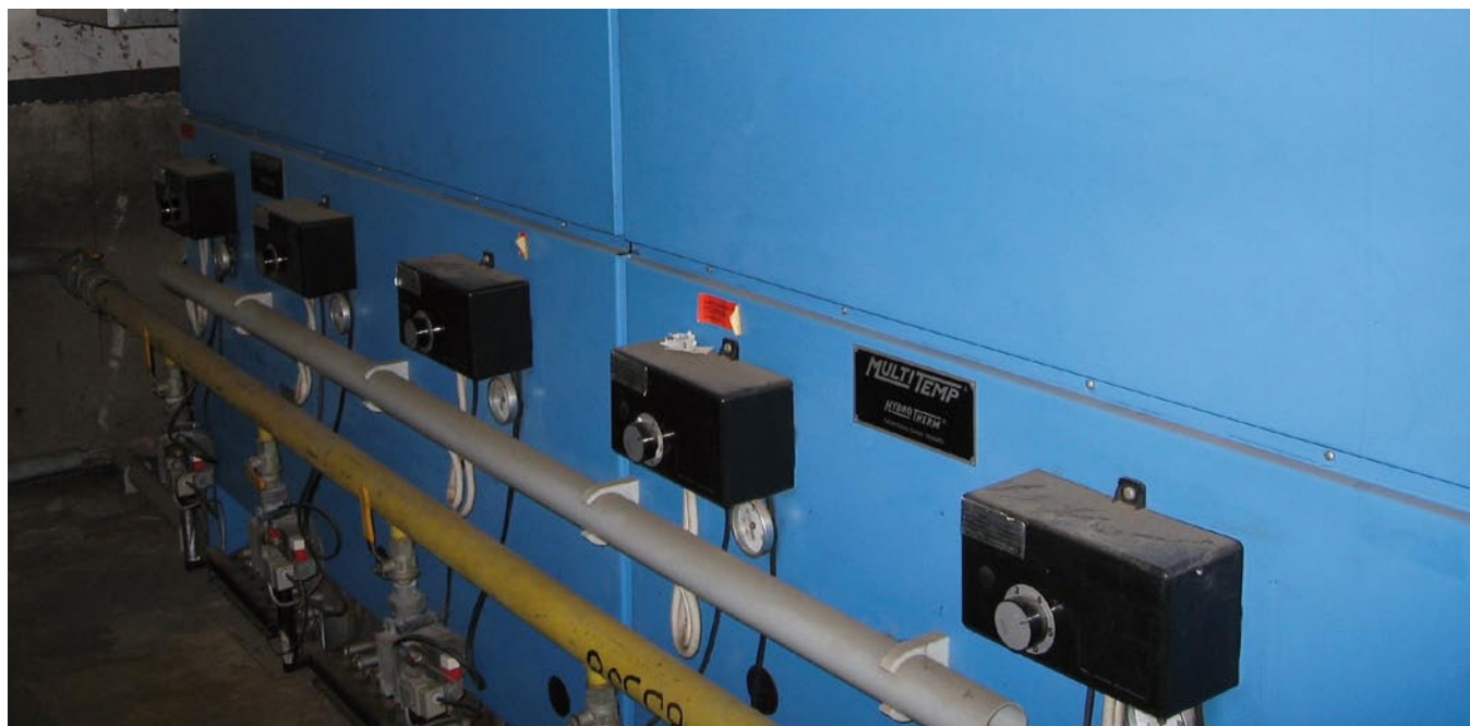
Eine Modernisierung ist die einzige Möglichkeit, um einem weiteren Ausfall der Heizungsanlage in Voerde vorzubeugen.
